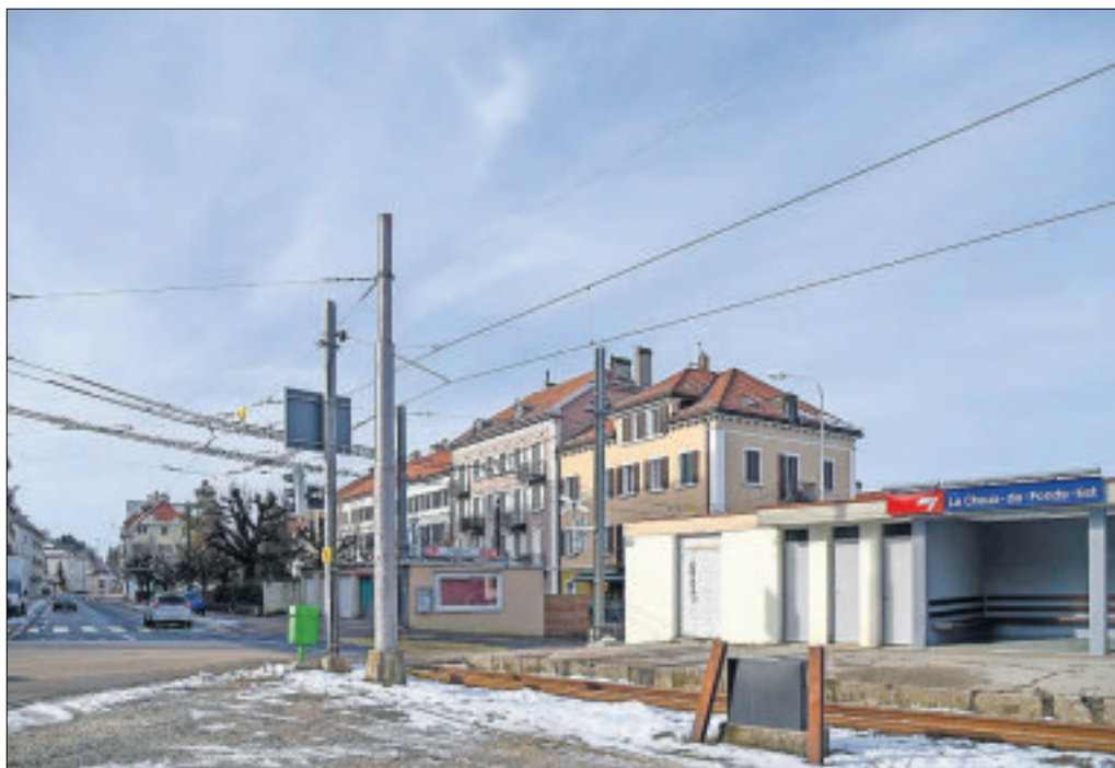
La gare de l'Est, la rue du Crêt et le pont de la Promenade seront en travaux au printemps 2017. PHOTO PJN
